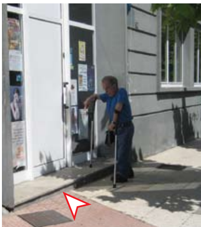
CAMBIOS DE NIVEL EN EL ACCESO de los edificios públicos y en los locales de negocio, cuyos escalones y escaleras limitan a una parte muy importante de la población el acceso y disfrute de los mismos.
