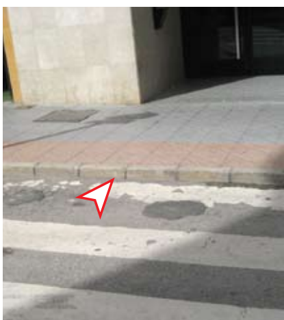
ACERAS SIN REBAJES cuyos bordillos limitan la libre circulación de las personas al cruzar por un paso de peatones.
