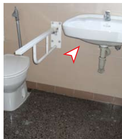
LA FALTA DE ASEOS ADAPTADOS en playas, parques, espectáculos al aire libre, o la mala colocación de los sanitarios y complementos.
