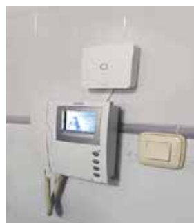
Dispositivo de apertura del portal con teléfono móvil.
